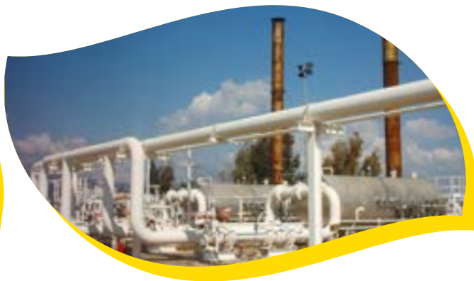
Projet: Connexion entre les stations de mesure et de réduction de Zara (A) et Zara (B) Client: SYRIAN GAS COMPANY Année: 2006
