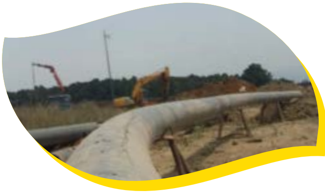
■ Projet: Déviation et Reparation Du pipe GPL q10" à sisi arcine - blida au niveau de BIR TOUTA Client: NAFTAL Année: 2016
