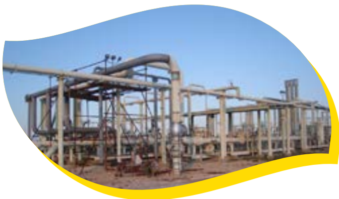
Projet: Connexion entre les stations de mesure et de réduction de Zara (A) et Zara (B) Client: SYRIAN GAS COMPANY Année: 2006
