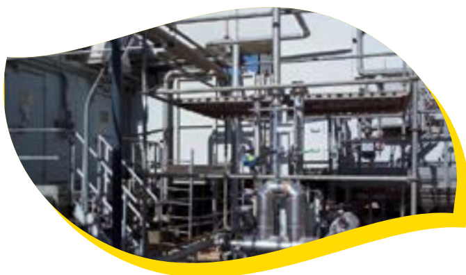
■ Projet: Convention au gaz naturel du system combustible liquid des turbines TP1,TP2 & TP3 de lactation de pompage N.2 DJAMAA OK 1/34' Client: BAKER HUGHES a GE Company Année: 2019
