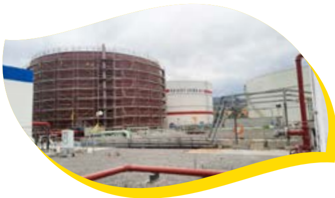
■ Projet: JJEL 1.398 MW CCPP Client: HYUNDAI Engineering Co. LTD Année: 2021
