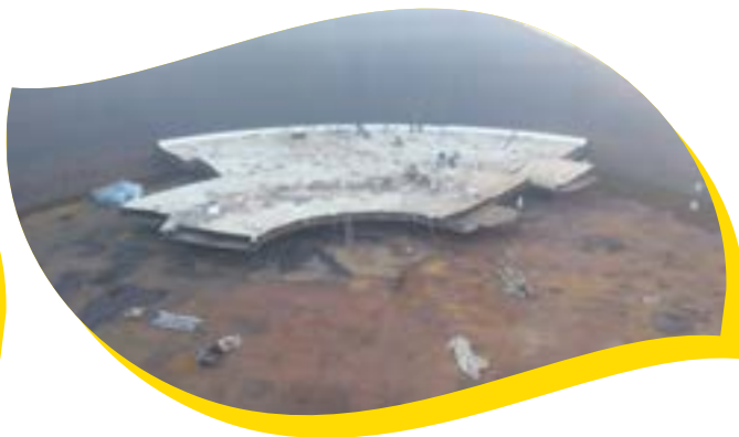
■ Projet: Réhabilitation du BAC N855° Terminal arrivée OZ1 28"BRUT-ARZEW Client: SONATRACH Année: 2021
